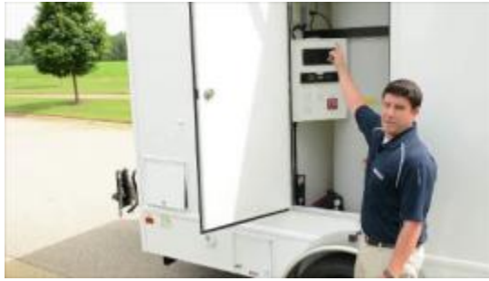
12 Volt Panel - Converter
